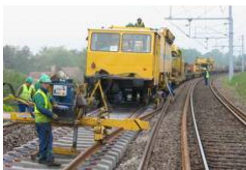
Longs Rails soudés sur traverses béton
