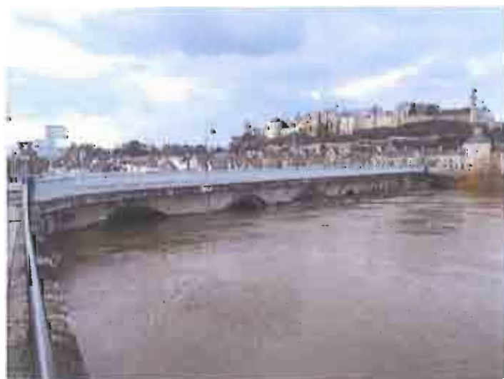
6 mars 2006 – 5.2 m au pont de Chinon - rive gauche amont
